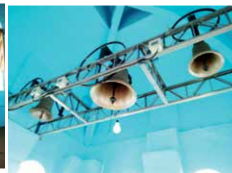
Sinos e o mecanismo automatizado instalados após a reforma
